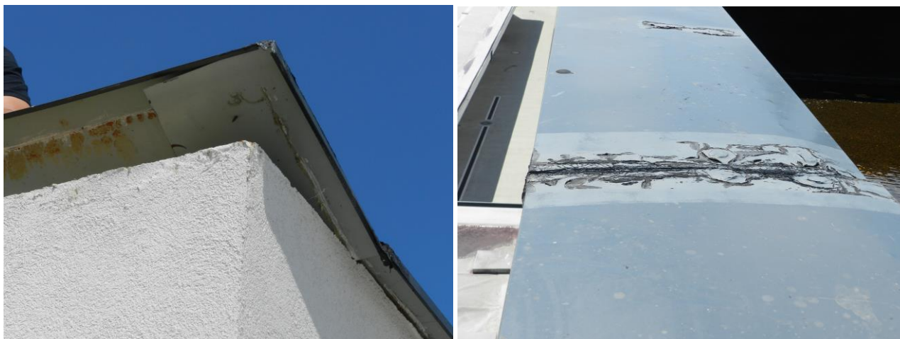
Obr. 5 Absencia kotvenia oplechovania atiky (vľavo), nesprávne vzájomne spojenie plechov v rámci oplechovania atiky (vpravo)
