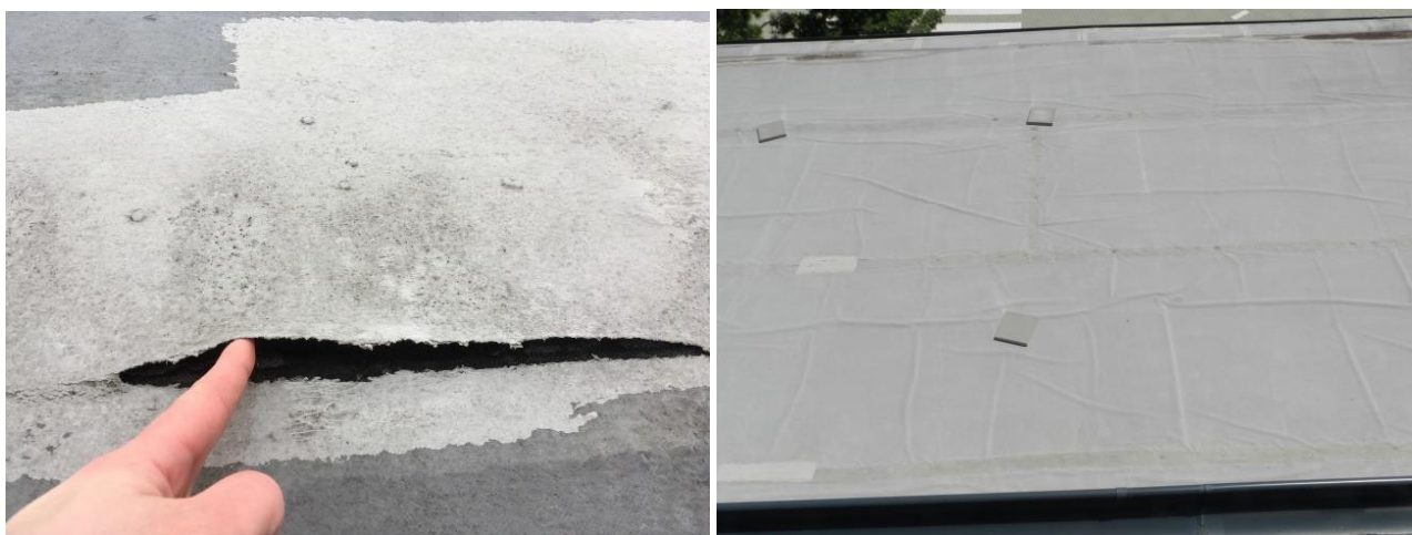
Obr. 2 Trhlinka v spoji geotextílie (vľavo), zvltnená povlaková krytina spolu s betónovými platňami (vpravo)
