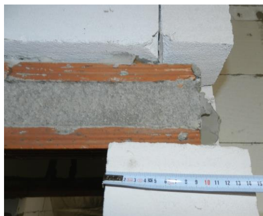
Obr. 10 Preklad s nedostatočnou dĺžkou uloženia a zlou orientáciou
