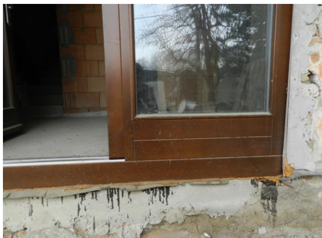
Obr. 11 Absencia hydroizolačnej úpravy
