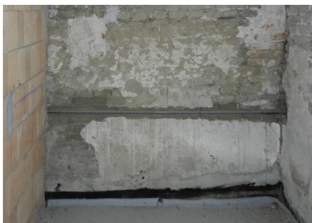
Obr. 5 Vedenie rúry v škáre muriva z nepálenej tehly; trhlina v kúte
