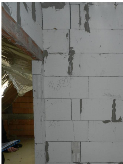
Obr. 7 Zvislá trhlinka v stene 2.NP
