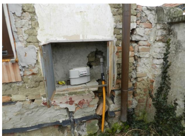
Obr. 6 Výklenok v škáre muriva z nepálenej tehly; odvodnenie strechy priamo ku základu; absencia hydroizolácie spodnej stavby
