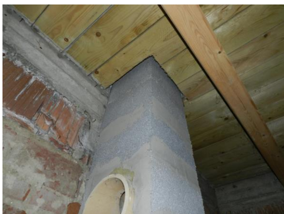
Obr. 9 Nedostatočne veľké odstupy horľavých konštrukcií od telesa komína
