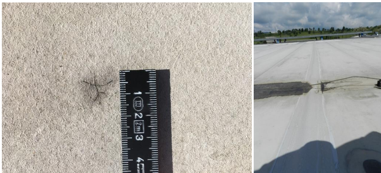
Obr. 3 Veľkosť trhliny povlakovej krytiny mPVC v dôsledku nedostatočnej hrúbky (vľavo), preplepená pozdĺžna trhlina povlakovej krytiny mPVC v dôsledku teplotného šoku (vpravo)
