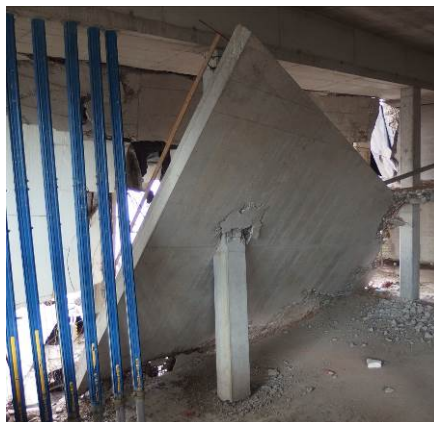
Obr. 1 Typické porušení desky protlačením okolo sloupu
